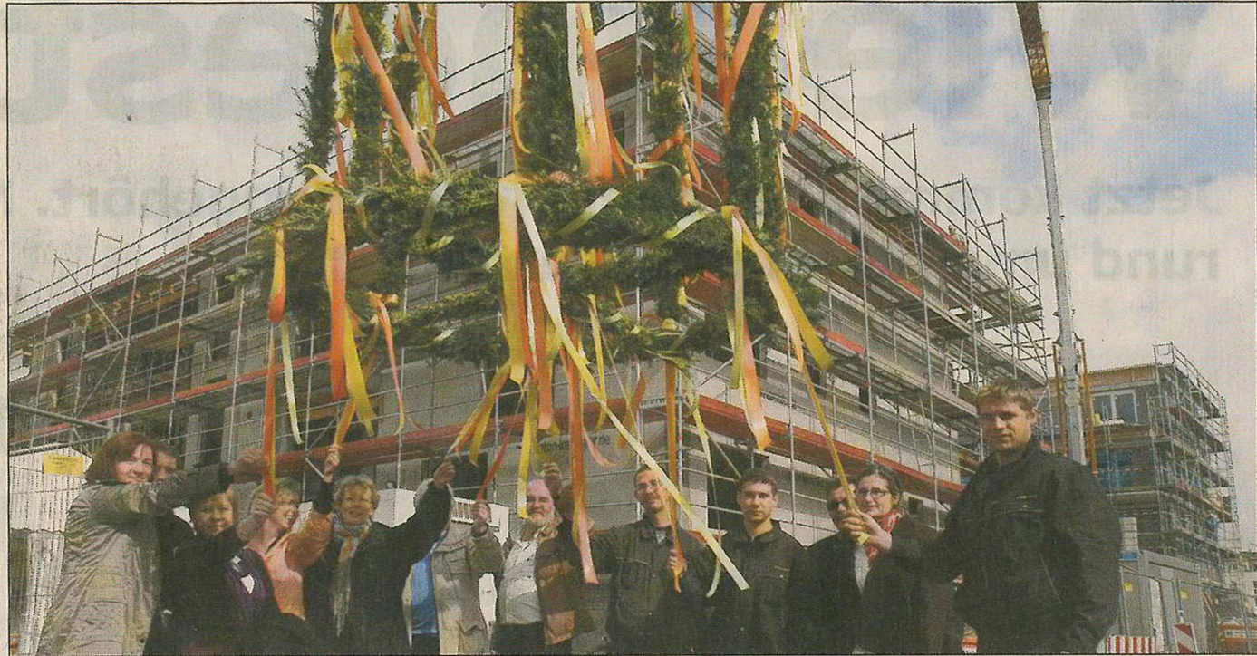
Richtfest in Kranichstein: In der Borsdorffstraße entstehen Häuser, deren Energieverbrauch relativ niedrig sein soll.
